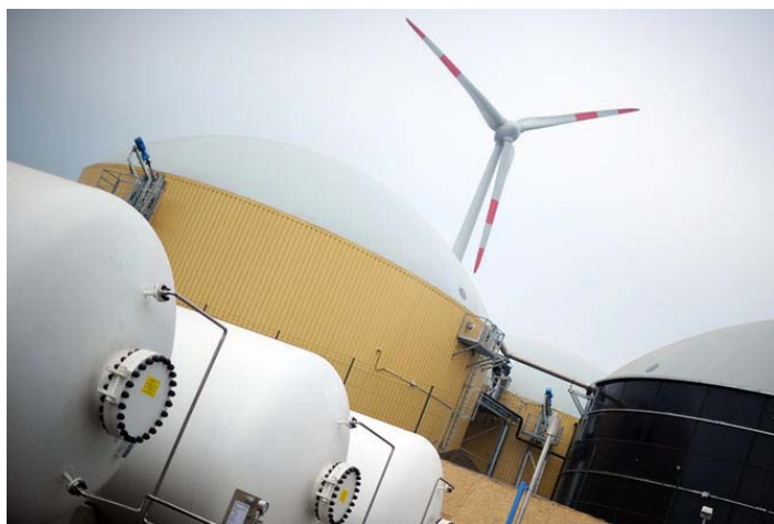
Inaugurée en 2009 à Prenzlau (Allemagne), cette centrale hybride produit de l'électricité, de la chaleur et de l'hydrogène à partir de sources d'énergies renouvelables. JOHANNES EISELE / AFP
