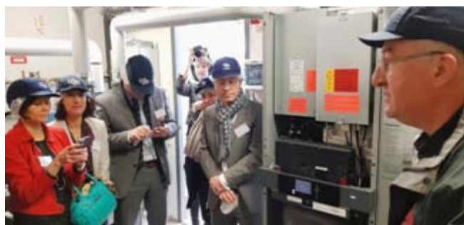
La chaudière pile à combustible du gymnase du Bois au coq au Havre a été inaugurée le 14 décembre 2017.
